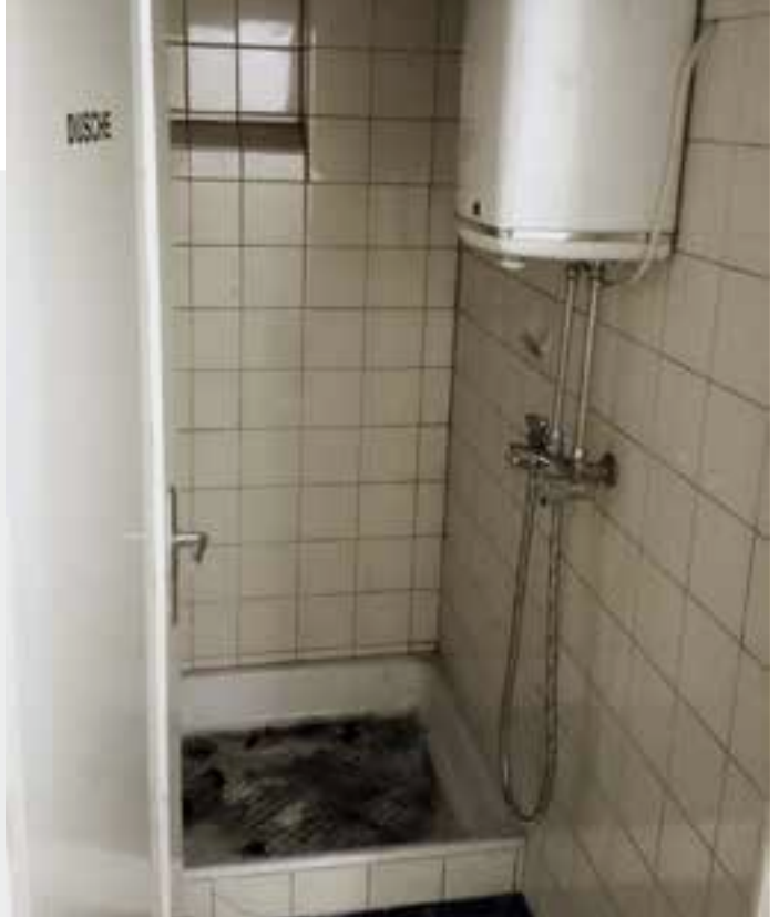
In kommunalen Einrichtungen herrscht ein teilweise erschreckender Investitions- und damit Sanierungsstau. Das Bild zeigt die Dusche in dem Spritzenhaus der Freiwilligen Feuerwehr einer Kleinstadt in Ostwestfalen.
