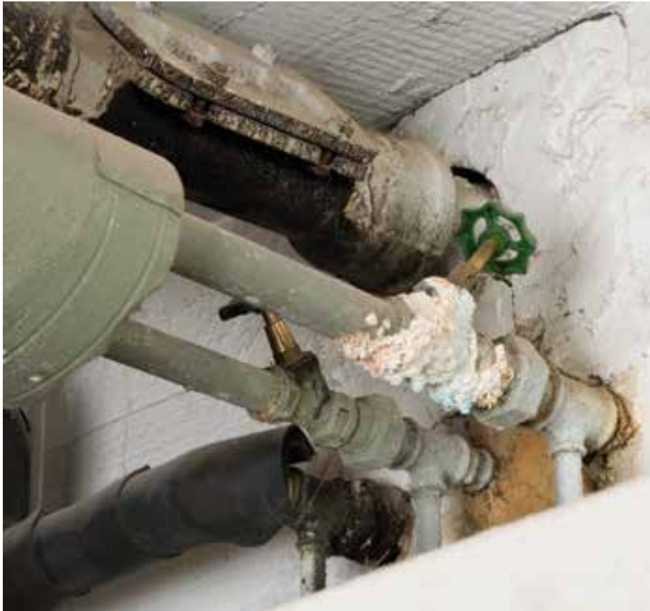
Zustandsbetrachtung, sinnigerweise aus einem niedersächsischen (!) Krankenhaus, kurz nach Beginn der Kernsanierung des Gebäudeflügels: Wenige Wochen vorher waren auch diese Rohrleitungen – prototypisch dargestellt für die Gesamtheit der Heizungs- und Sanitärinstalltionen – noch in Betrieb...
